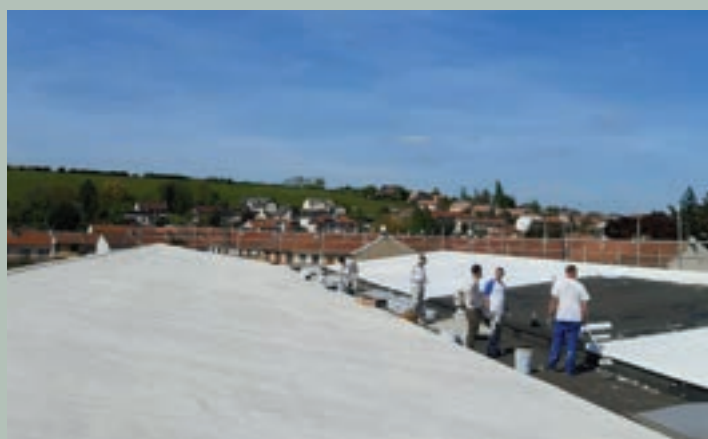
Rénovation d'étanchéité de la toiture du bâtiment St Exupéry par application d'un film de couleur blanche améliorant le confort d'été
